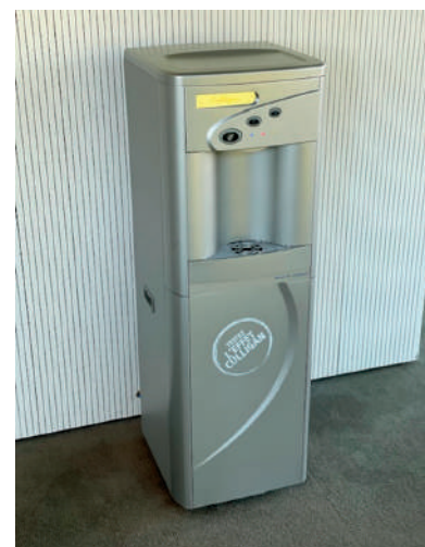
Fontaine à eau présente sur site
